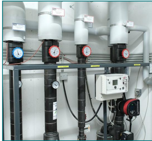
Monitoring der Heizungsanlage
