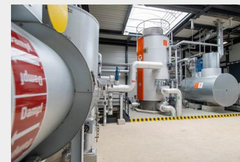
Elektrodenkessel zur Prozessdampf-Erzeugung Quelle: Currenta
