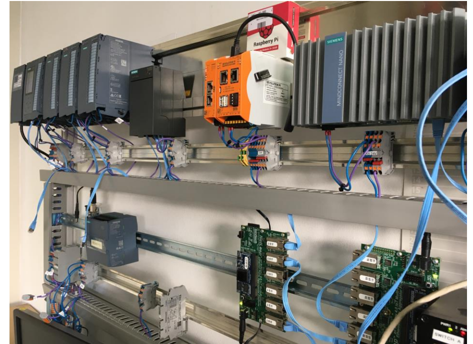
Steuerungstechnik: die technische Seite der Automatisierung
